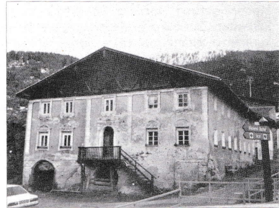
Das alte Widumhöfl mit deutlichen Zerfallerscheinungen. Unter dem Putz der Westseite gäbe es schöne Malereien.
