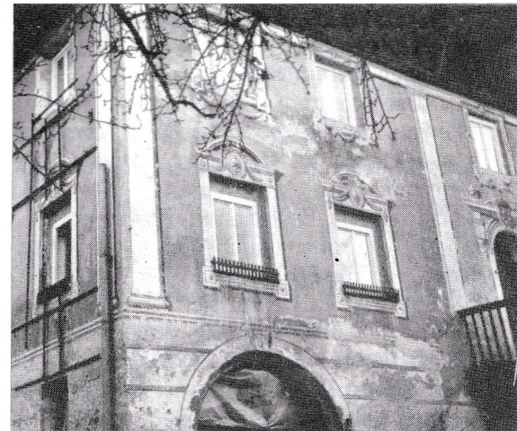
Die einst so prunkvolle Fassade - jetzt verwahrlost und häßlich. Wer finanziert die Restaurierung dieses wertvollen, traditionsreichen Hauses ?
