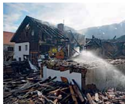
Ein Bild der Zerstörung bot sich den Einsatzkräften nach den Löscharbeiten
