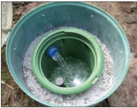
Brunnenstube mit neuem, innenliegendem Behälter
