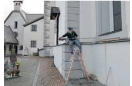
Für die Beschallung des Friedhofs mussten die Arbeiter der Fa. Mösl mit einem 1,60 m langen Bohrer durch die Kirchenmauern bohren.
