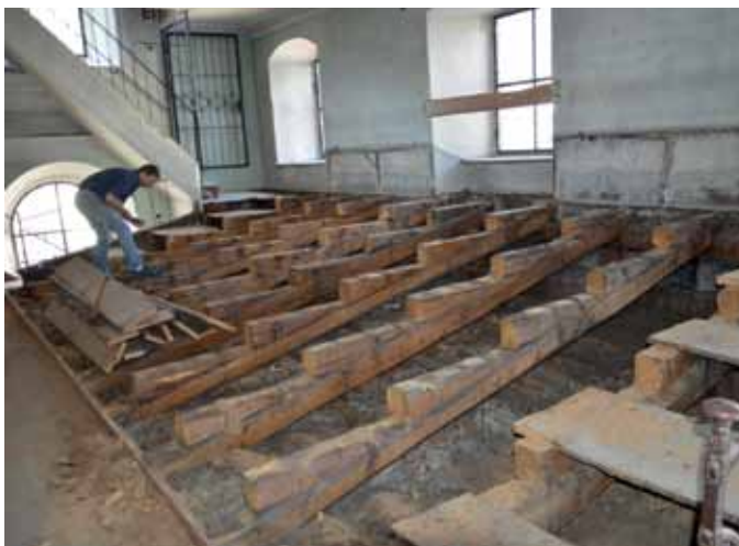
Arbeiter der Fa. Hosp beim Abtragen des Gestühls und des Bodens auf der Empore
