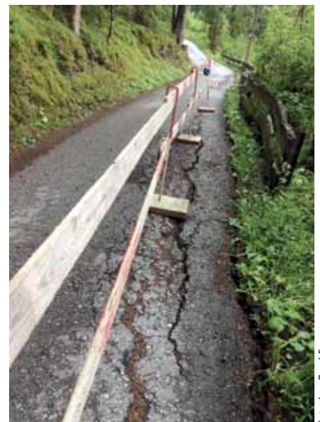
Am Sendersweg ist das talseitige Bankett auf eine Länge von ca. 15 bis 20 m abgebrochen.
