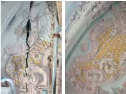
Die Risse und Schäden waren sehr groß – vorher (li.) und nachher (re.)
