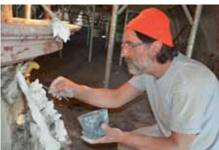
Aufgrund von Wasserschäden mussten viele Stuckteile ergänzt bzw. erneuert werden.
