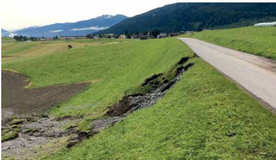
Böschungsetzung im Bereich Bachl/Gruben
