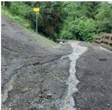
Auch der Panoramaweg wurde auf einzelnen Wegabschnitten förmlich ausgespült.
