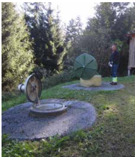
Quellstube und Behälter werden durch den Wassermeister der Gemeinde, Gerhard Winkler, regelmäßig inspiziert und gewartet.
