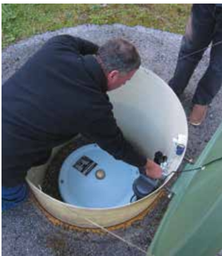
Der Wasserstand im Behälter wird elektronisch überwacht.
