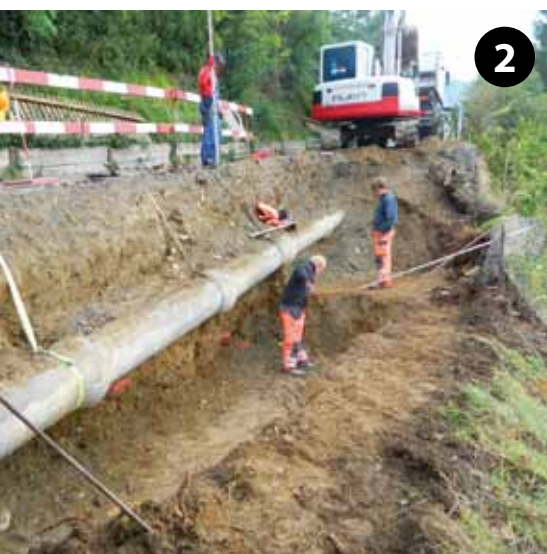
2 Bestehende Grenzmauer wurde abgerissen, Fundament wird abgestuft ausgehoben, bestehender Regenwasserkanal muss in Betrieb gesichert werden.
