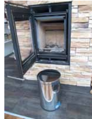
Foto: ATM Aschenabfälle dürfen nur in Metallbehältern gelagert werden.
