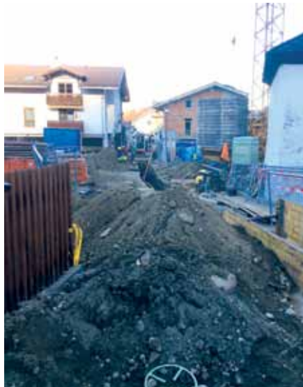
Die über 100 Jahre alte Wasserleitung aus Eisen wurde erneuert. Fotos: Ing. René Sarg
