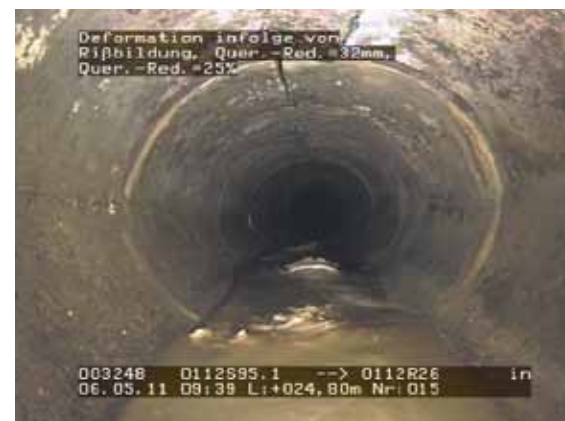
Beispiel eines beschädigten Kanals
