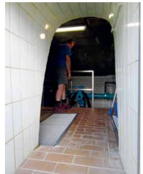
Im Inneren des Zwischenbehälters
