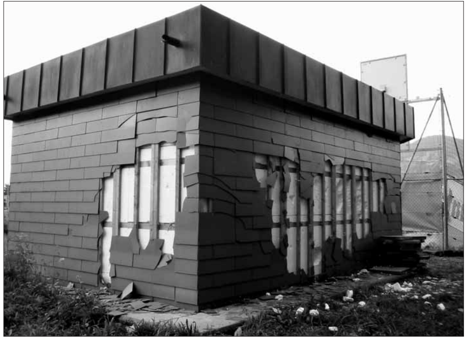
Vandalismus am Tiefbrunnen
