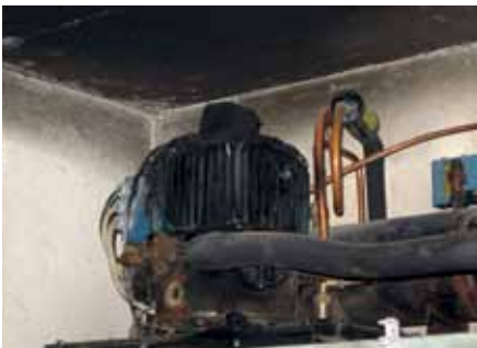
Der Kühlkompressor auf dem Wandvorsprung
