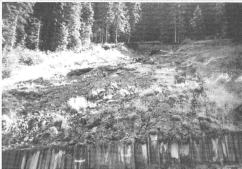
Gefährliche Lizumstraße! Der Regen führt mitunter zu Bodenabbrüchen.
