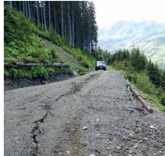
Hier droht der Forstweg im Nederschlag abzurutschen.
