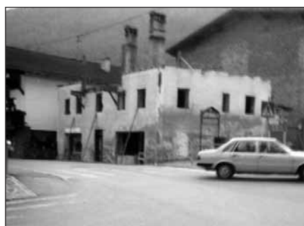
Abriss des vorderen Bieriger-Winkler Hauses nach der Murkatasrophe 1983.
