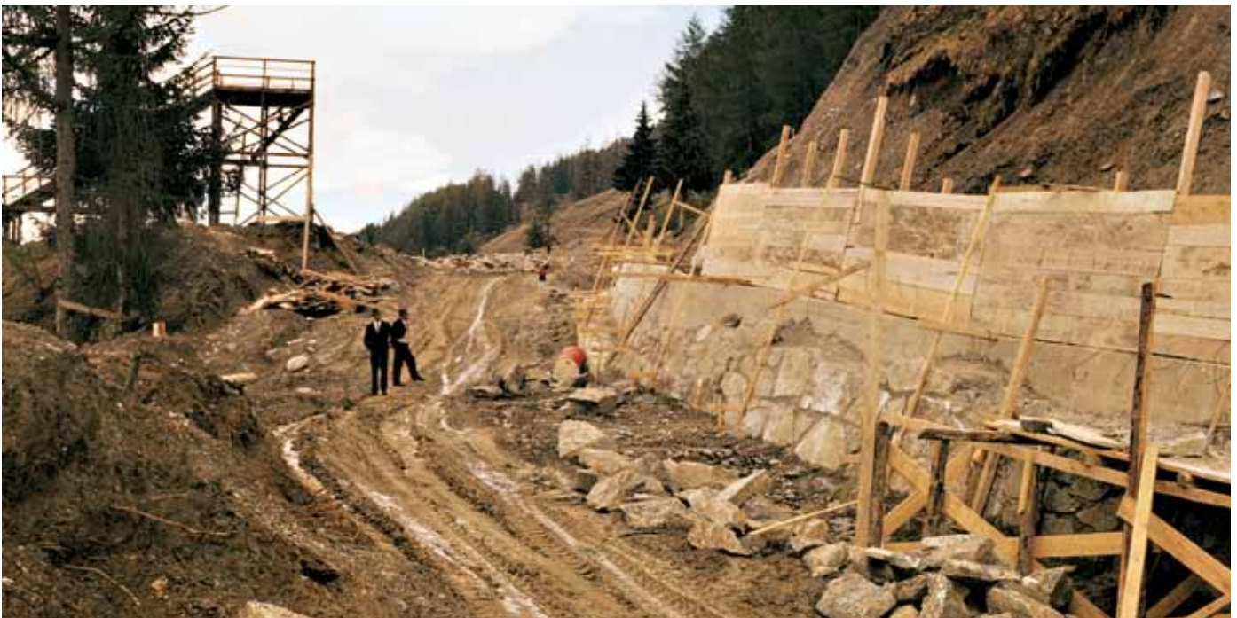
Bau der Straße in die Axamer Lizum anlässlich der Olympischen Winterspiele 1964. Auf dem Bild ist noch der Turm der ehemaligen Schisprunganlage zu sehen.
