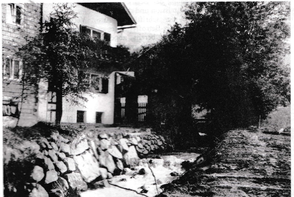
Über die Instandhaltung der Brücke beim Omesmüller braucht niemand mehr zu streiten: der Bach hat sie kurzerhand mitgerissen.
