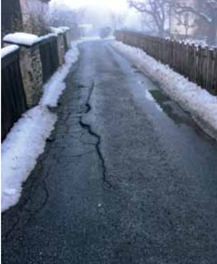
Sichtbare Straßenschäden aufgrund des strengen Winters
