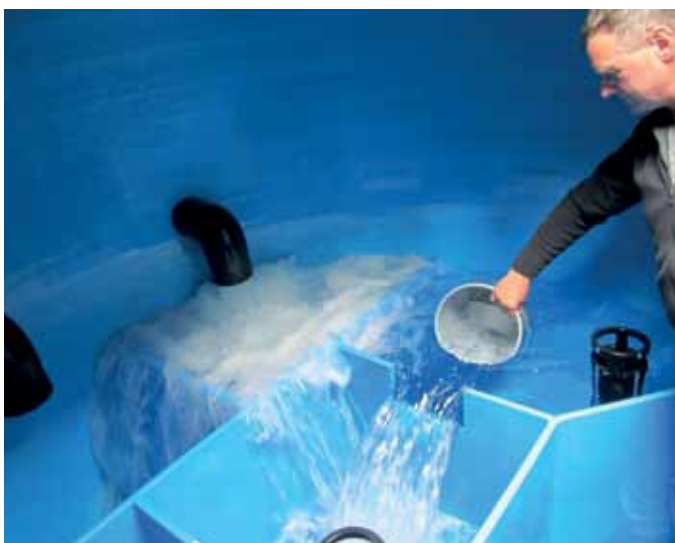
Zur Druckreduzierung wird das Wasser über vier Unterbrecherschächte durch das Axamer Tal bis zum Hochbehälter Knappen (1.000 m Seehöhe) geleitet.
