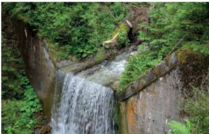
Wildholz, wie beispielsweise Wurzelstöcke, muss aus dem Abflussbereich beseitigt werden.
