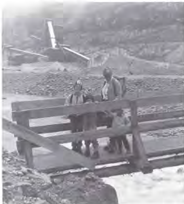
Für die 150 m hohe Gewölbemauer liefert ein riesiges Schotterwerk das nötige Material. Während der Bauarbeiten wurde der Ziller in ein neues Bachbett verlegt. Derzeit leben auf der Baustelle mehr Arbeiter, als die Gemeinde Einwohner hat.
