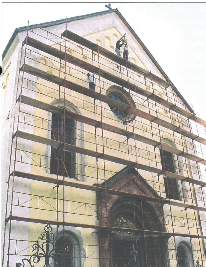
Die Westfassade ist eingerüstet. In den obersten Etagen (v. l.): Raimund Winkler, Hans Pondorfer, Walter Perfler.
