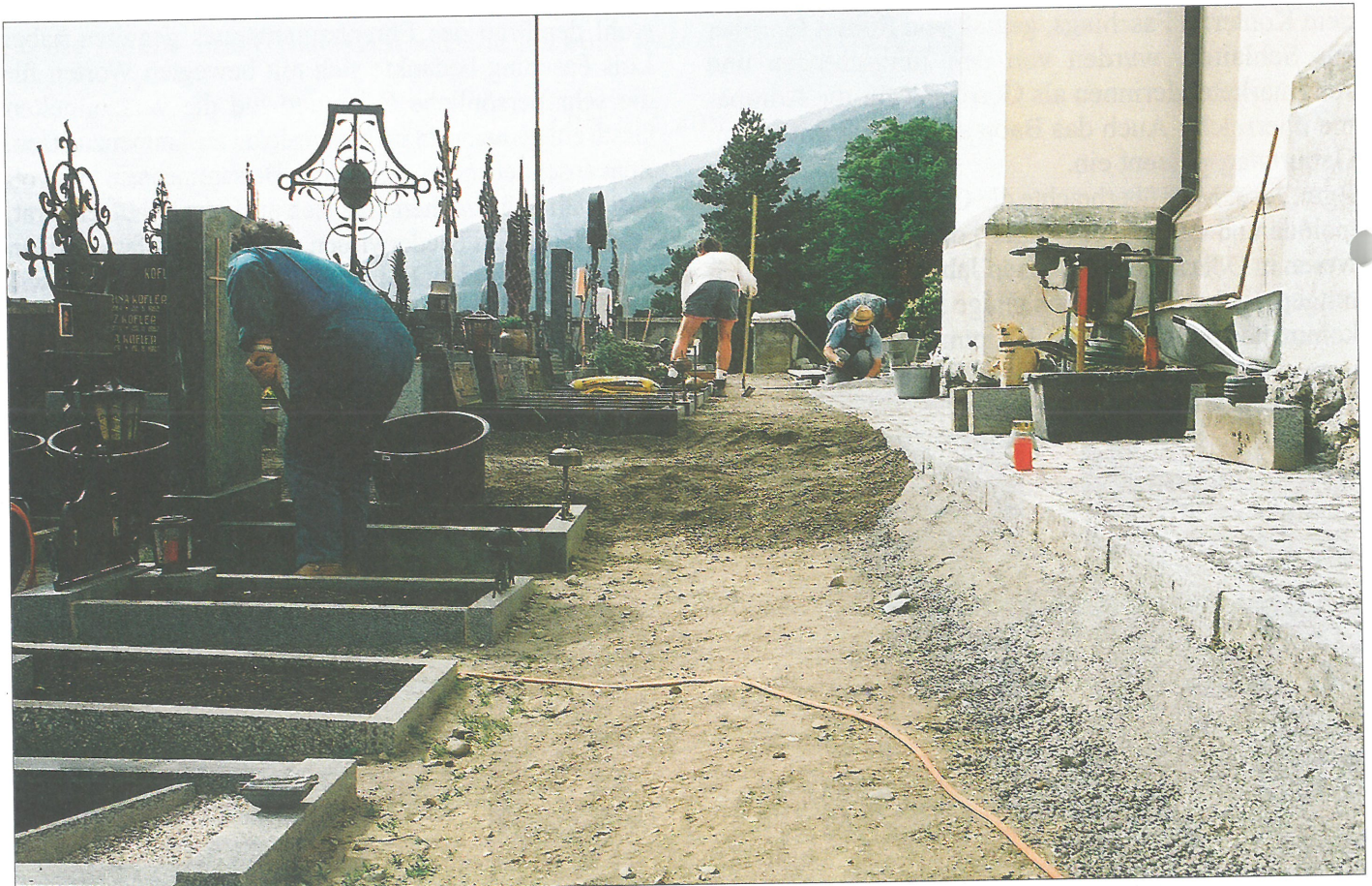
Die Angleichung des Friedhofsareals südlich der Pfarrkirche an das Niveau der neuen Pflasterung erfordert eine Hebung der Gräber bis zu 50 cm. Foto: DI Franz Mair
