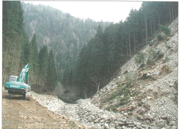
▲ Der Debantbach wurde an die westliche Talseite verlegt, der Hang mit einer Steinschlichtung abgestützt.
