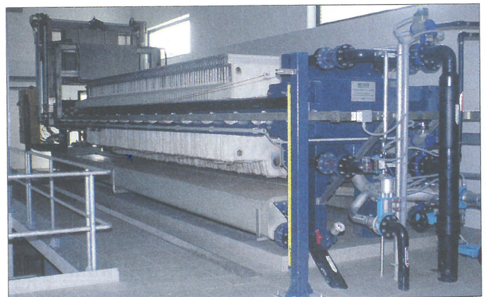
Mit einem Druck von über 50 bar wird das Wasser aus dem Klärschlamm gepresst.
