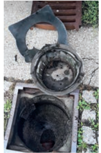
Der Aufbau eines Einlaufschachtes. Im Gitterkorb sammeln sich Schmutz und Laub.
