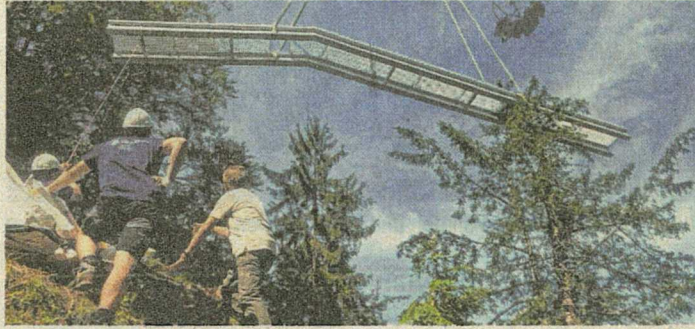
Eine fast eine Tonne schwere Stahlbrücke wurde per Heli eingeflogen und bietet einen sicheren Übergang an einer heiklen Stelle.
