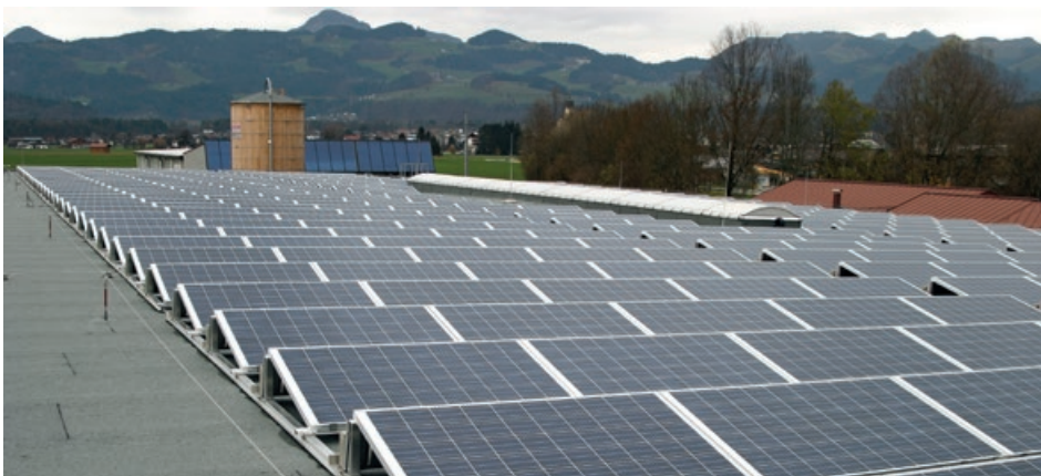
Die neu errichtete Photovoltaikanlage beim Wertstoffsammelzentrum der Gemeinde Ebbs.
