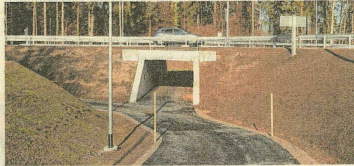
Die ersten Runden im Kreisverkehr werden gedreht. Radfahrer und Fußgänger kommen über die neue Unterführung sicher an ihr Ziel. Foto: Zerlauth
