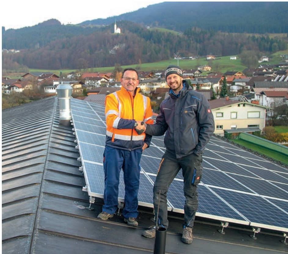
Nach der technischen Überprüfung und Abnahme der neuen Anlagen übernimmt Schulwart Hans Mayer diese von Michael Anker, Geschäftsführer der Firma Strom vom Dach aus Erl.
