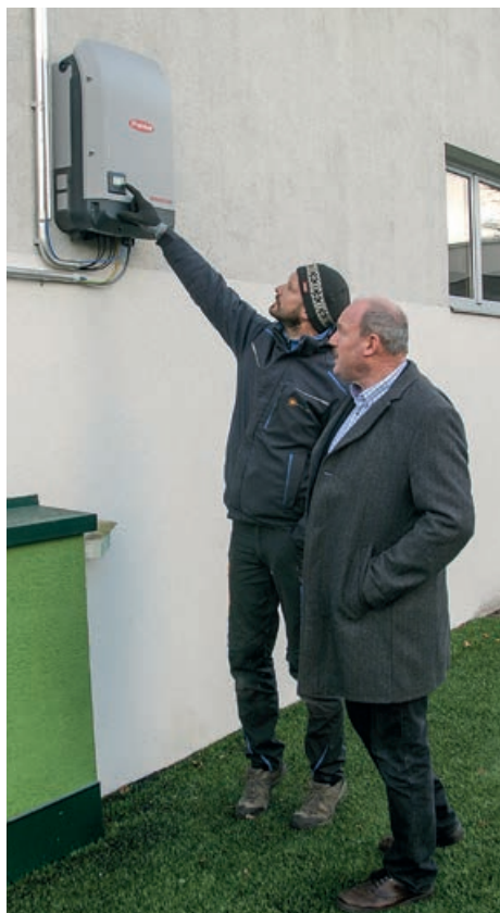
Am Wechselrichter für die Sporthalle überprüft sich Bgm. ÖkR Josef Ritzer von der Funktionstüchtigkeit der neuen Anlage.
