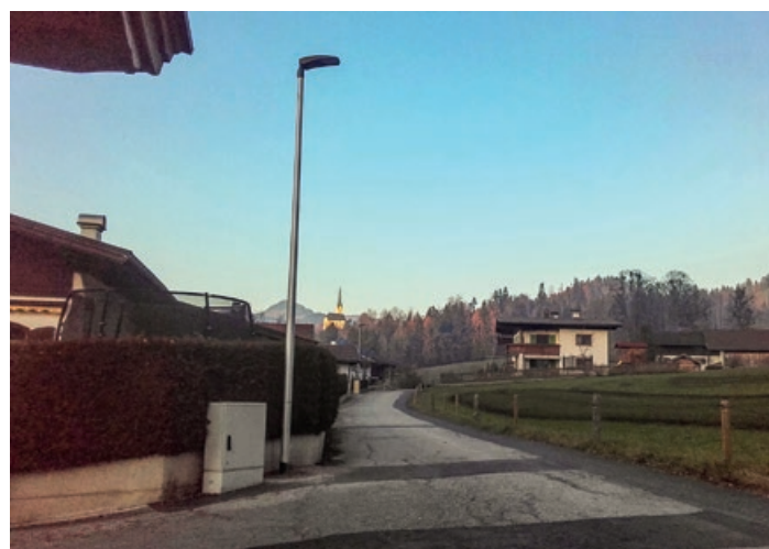
Im Zuge der Errichtung der Gas- und LWL-Leitungen wurde eine neue Verkabelung für die Straßenbeleuchtung verlegt.
