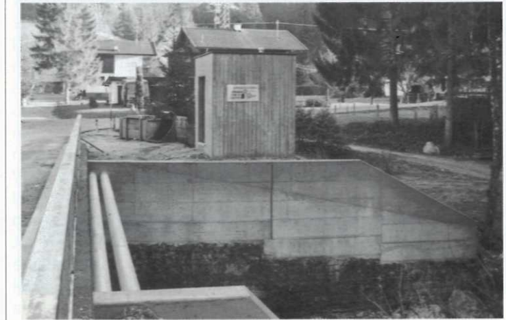
Die Pumpstation Brand bei der „Weberbrücke“ hebt die Abwässer über den Jenbach.
