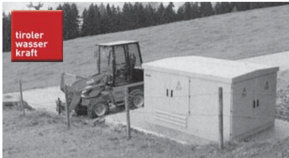
Der Trafo bei der Skiclubhütte.
