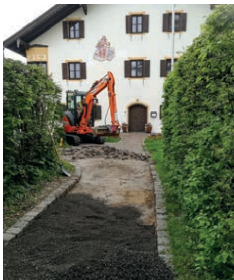
Abbruch der durch starke Setzungen sanierungsbedürftigen Pflasterung.
