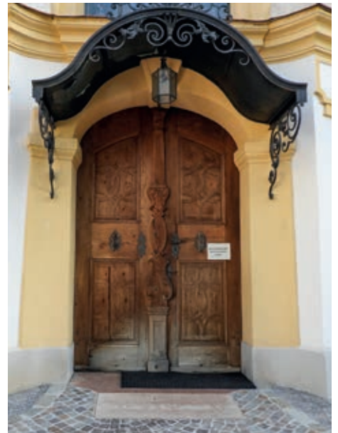
Der Eingang an der Südseite der Pfarrkirche ist seit kurzem barrierefrei zugänglich.
