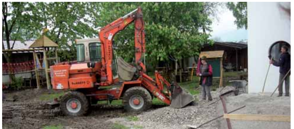
Unser Spielplatz – eine Baustelle! Auch die Mitarbeiter des Bauhofes waren bei der Spielplatzumgestaltung massiv eingebunden.
