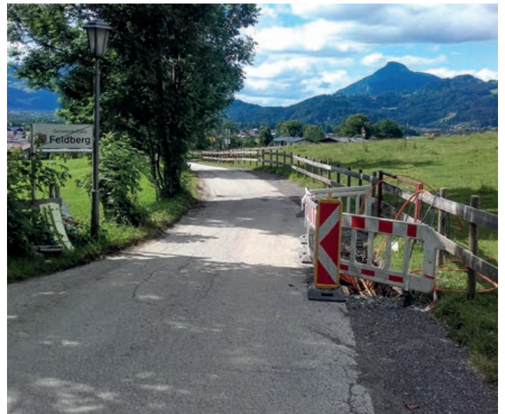
Am Feldberg starteten die Grabungsarbeiten für das Gas-Leitungsnetz sowie für das Glasfaser-Internet.
