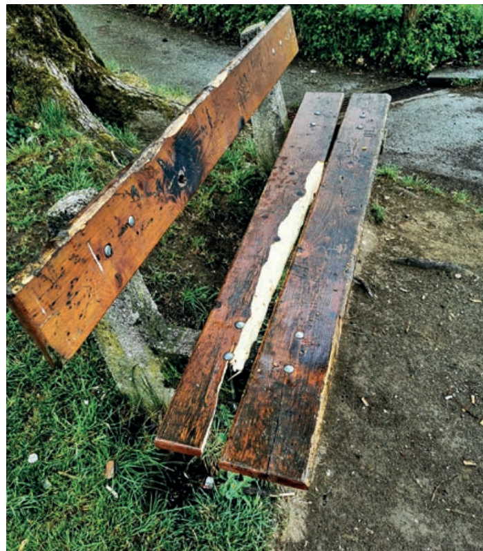
Die Sitzbank in der Kruck wurde leider mutwillig beschädigt.
