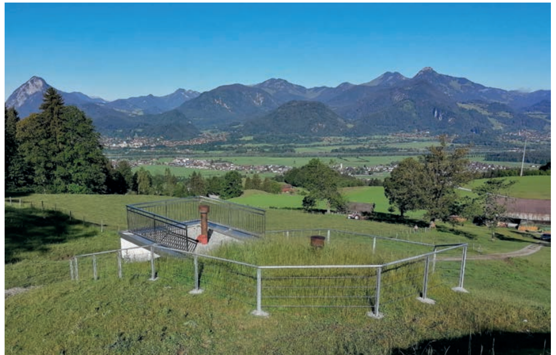
Die Einfriedung der Schieberkammer inklusive Wasserbehälter.
