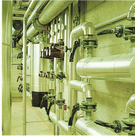
Heizzentrale mit Durchlauferhitzer und Notkühlung Gasmotoren
