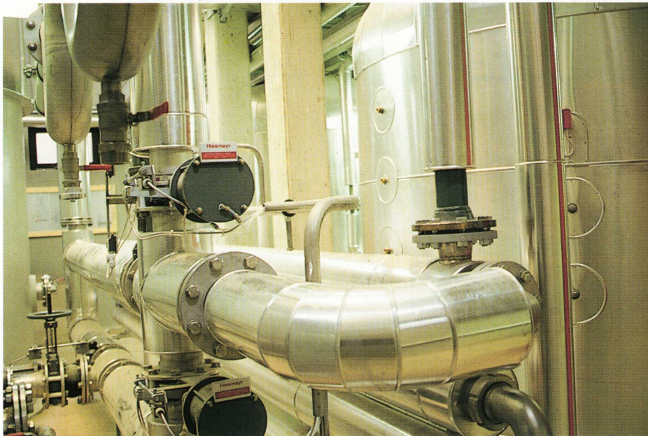
Wärmetauscher der Hygienisierungsanlage
