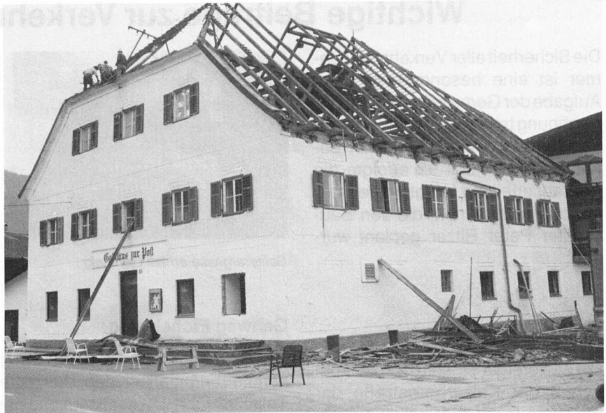
Ende Oktober 1992 wurde das altehrwürdige Gasthaus zur Post wegen arger Bauschäden abgetragen.
