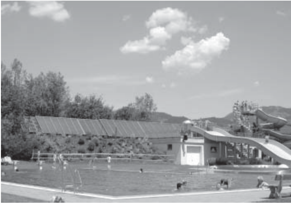
Die neue Solaranlage im „Hallo du“ fügt sich auch optisch gut in das Freibad ein.
