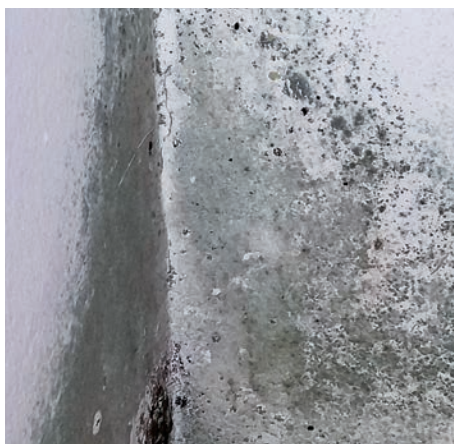
Schimmelbefall erfordert eine richtige Sanierungsmaßnahme. (Fotonachweis: Energie Tirol)
