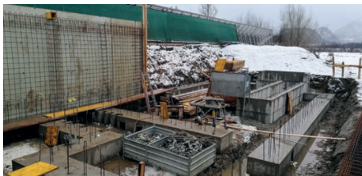
Vor kurzem wurde mit der Errichtung der weiteren Panoramasauna begonnen. Der Betriebsstart ist für Mitte Mai geplant.
