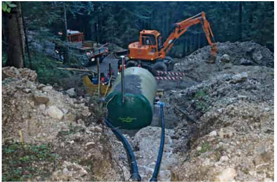
Die neue Fertigteilbrunnenstube in der offenen Baugrube. Die beiden „Pfarrerrug-Quellen“ werden hier eingeleitet.
