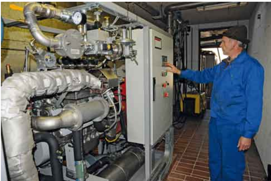
Das neue Blockheizkraftwerk bewährt sich bestens.
