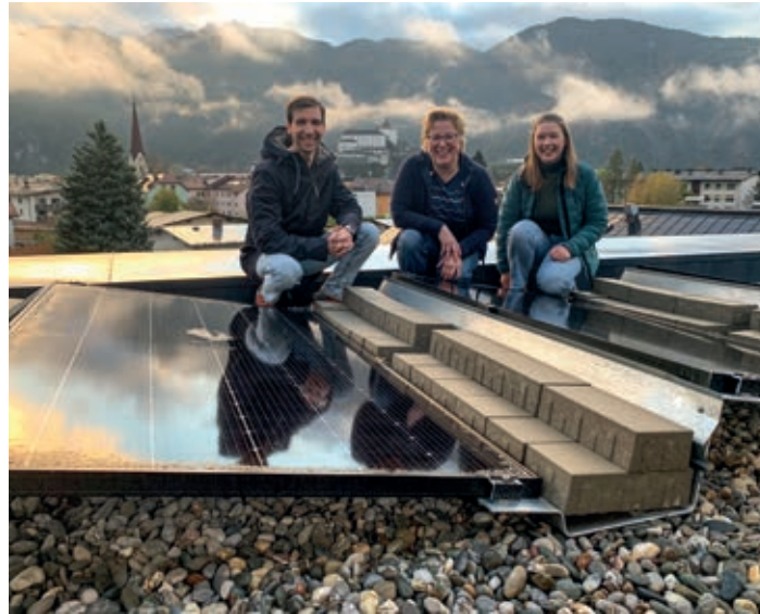
Am 16. September wurde die erste Photovoltaikanlage in Kufstein durch den Partnerbetrieb „StromvomDach“ aus Erl errichtet (Fotonachweis: Regionalmanagement KUUSK).
