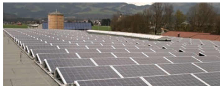
Die bestehende PV-Anlage beim Bauhof/Wertstoffsammelzentrum wird großflächig erweitert.
