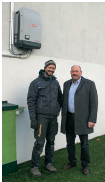
Michael Anker von der Firma Strom vom Dach bei der Übergabe der PV-Anlage an die Gemeinde.
