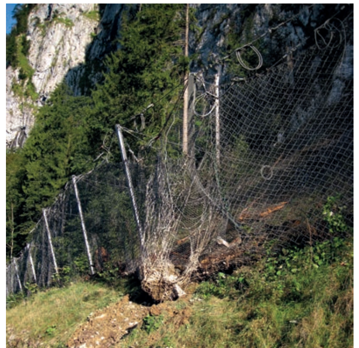
Die Firma HTB wurde mit der Beräumung der losen Gesteinsbrocken und umgefallenen Bäume beauftragt.
