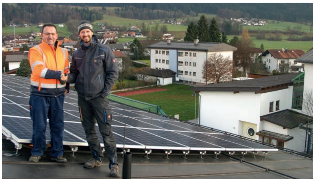
Bereits 2016 wurde eine PV-Anlage auf dem Dach der Mitteschule errichtet, eine weitere folgte kurz darauf beim Wertstoffsammelzentrum.
