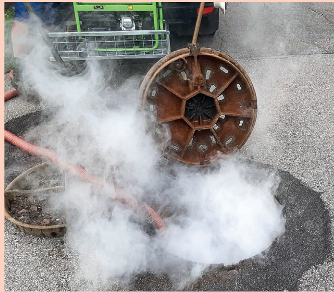
Mit der „Berauchung“ des Kanalsystems können nicht ordnungsgemäße Anschlüsse festgestellt werden.
