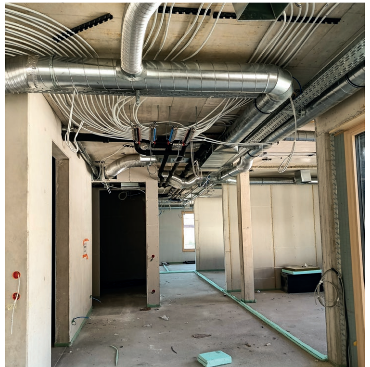
Ein Blick hinter die abgehängte Decke. Lüftungsrohre, Heiz- und Kühlrohre sind die vorherrschenden Elemente in der abgehängten Decke.
