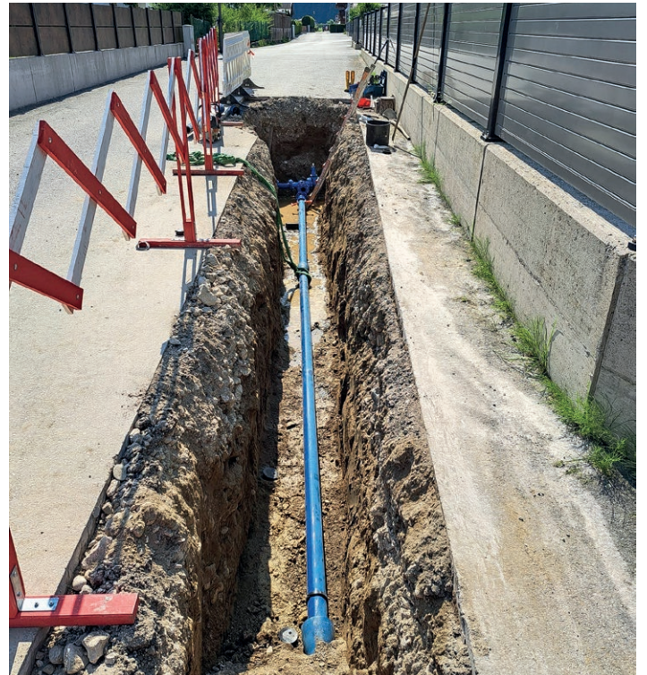
Die neu verlegte Gusswasserleitung soll wieder 60 Jahre lang zuverlässig Wasser zu den Haushalten transportieren.
