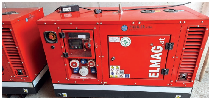
Die beim Gemeindebauhof eingestellten Notstromaggregate der Gemeinde Ebbs.
