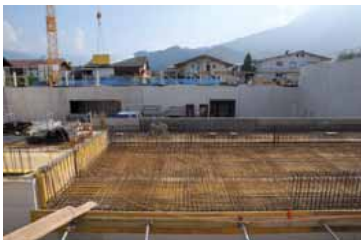
Blick auf die massive Armierung des Fundamentes, das mit einer 70 cm starken Fundamentplatte versehen wurde.
