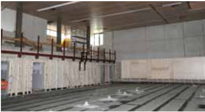
Die Fußbodenisolierung und die Decke sind bereits fertig und die Prallwände werden montiert.
