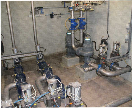
Frischschlamm- und Überschussschlamm- pumpen
