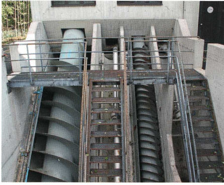
Zulaufbauwerk mit Abwasserhebung
