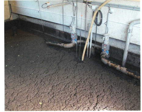
Schlammstapelraum mit Abtransport zur Kläranlage Kufstein
