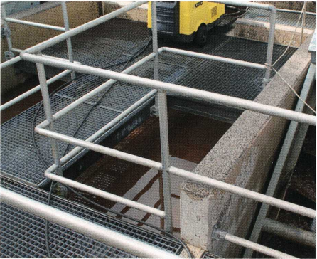
DENI-Becken mit Rücklaufschlammschnecke
