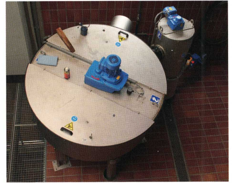
Maschinelle Schlamm- eindickung
