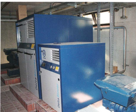
Gebläsestation und Druckluftanlage
