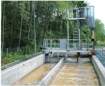
Belüfteter Fett- und Sandfang
