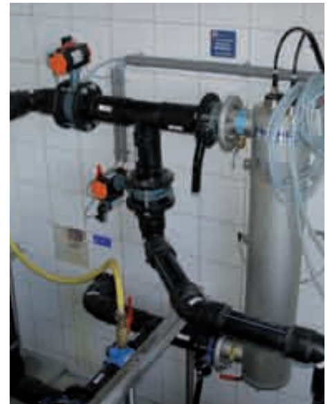
UV-Entkeimungsanlage im Hochbehälter Oberbuchberg.
