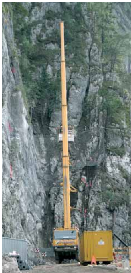
Ein großer Baukran ermöglicht die Anbringung von Schutznetzen über dem künftigen Portalzugang.
