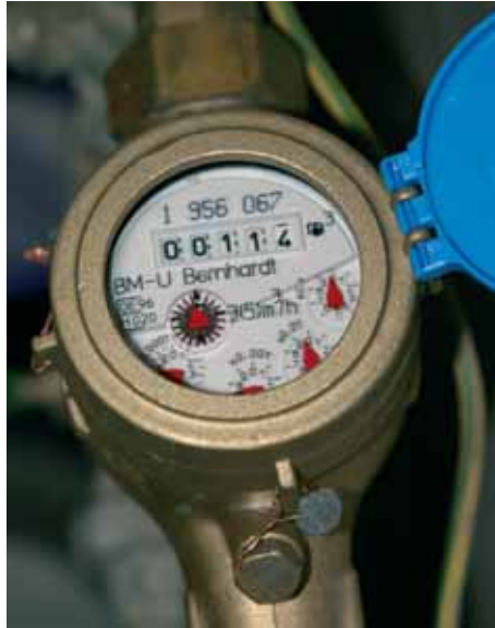
Ein regelmäßiger Blick auf den Wasserzähler erspart bei Leitungsdefekten unnötige Mehrkosten.
