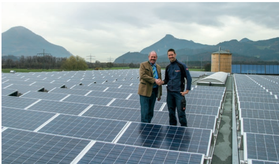
Auf dem Dach des WSZ wurde eine Photovoltaikanlage errichtet. Michael Anker von der Firma „Strom vom Dach“ mit Bgm. ÖkR Josef Ritzler bei der Übergabe der Anlage.
