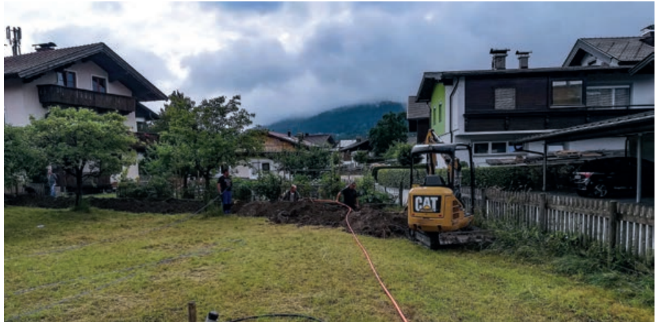
Im Dorfzentrum finden derzeit die letzten Verlegungsarbeiten für das schnelle Internet statt.
