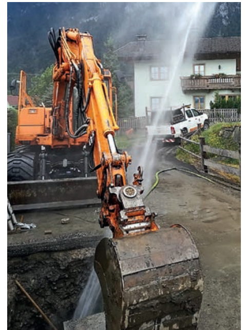
Im Falle eines Wasserrohrbruches oder eines Verdachts verständigen Sie bitte sofort das Gemeindeamt unter der Telefonnummer 05373/42202-120 (Bauamt).
