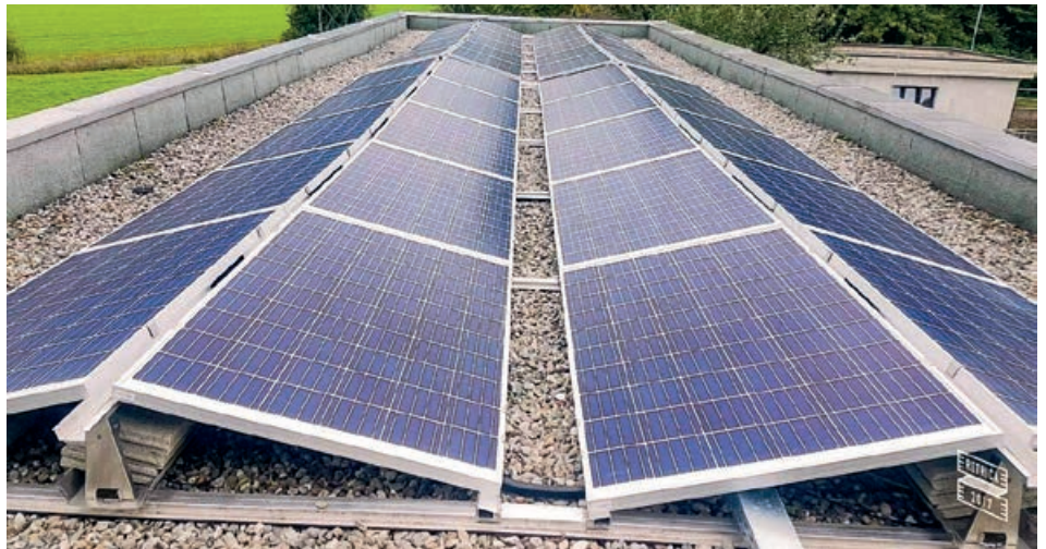
Die neue Photovoltaikanlage auf dem Dach der Verbandskläranlage der Unteren Schranne.
